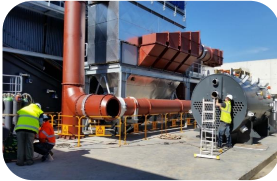
Brouwer Biocentrale Houtgestookte centrale (WKK), Balkbrug € 4,3 miljoen Eigen vermogen en lening
